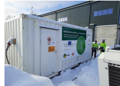
Hiilidioksidin puhdistus- ja nesteytyskontti. Kuva: VTT
